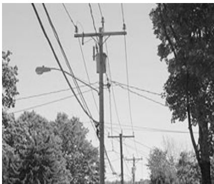
Gambar 1.1. Saluran Udara Tegangan Menengah (SUTM)
